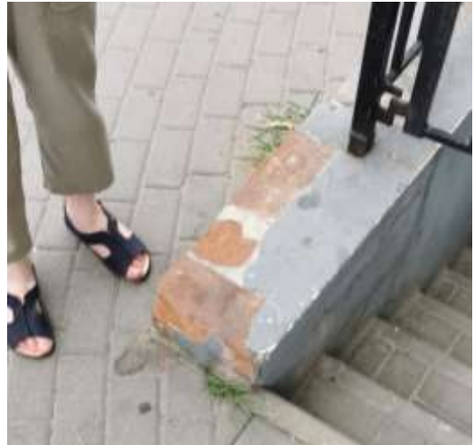
Zdj. Niebezpieczny murek
