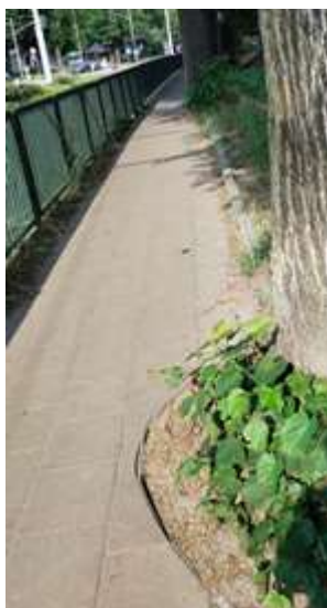
Zdj. 18 Chodnik pomiędzy przystankiem tramwajowym Powstańców Warszawskich, a Paska – zwężenie chodnika ze względu na rosnące drzewo
