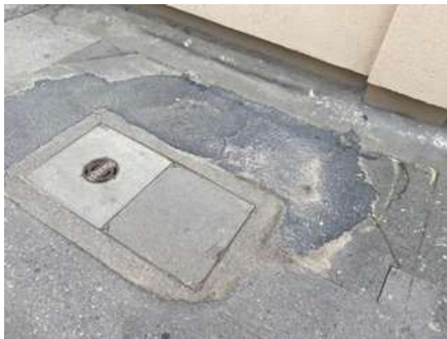
Zdj.14 Chodnik między nr 68 a 126 – nawierzchnia dziurawa, łataną, nierówna
